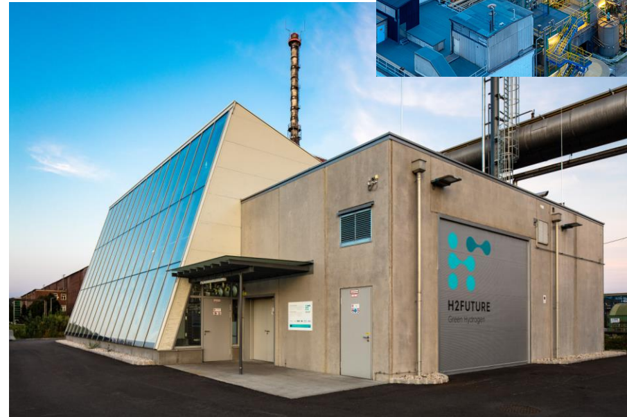
H2Future Elektrolyseur, voestalpine Linz
